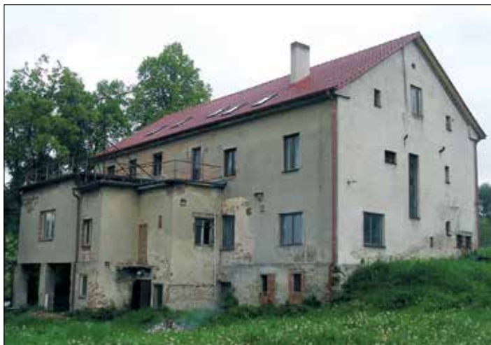
Ⓛ Dům jako ruina, před opravou
